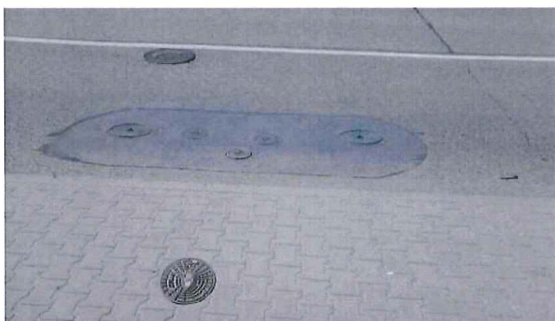
Obrázek 12 V jízdnicích stopách vodovodní kohouty, vpusti nebo šachtové poklopy, častý nedostatek na komunikacích v Brně. I když by se pro hromadnou dopravu používal tišší trolejbus a vodovodní potrubí jsou z plastické hmoty, pořád se přenášejí otřesy a obtěžující hluk do obytných budov, místo u domu Vyhlídalova 3. Vjezd těžkých vozidel do této ulice by se měl zakázat.
