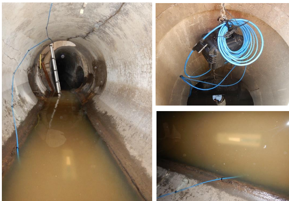
Obr. A1.2.2, A1.2.3 a A1.2.4 Ukázka instalace průtokoměru (MP01).
