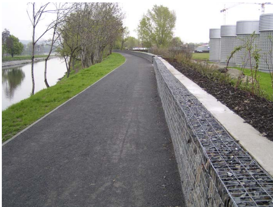
Obr. 4.8. Ukázka železobetonové protipovodňové zídky v kombinaci s gabiony a parkovou úpravou (Praha – Karlín u objektu Prague River City)
