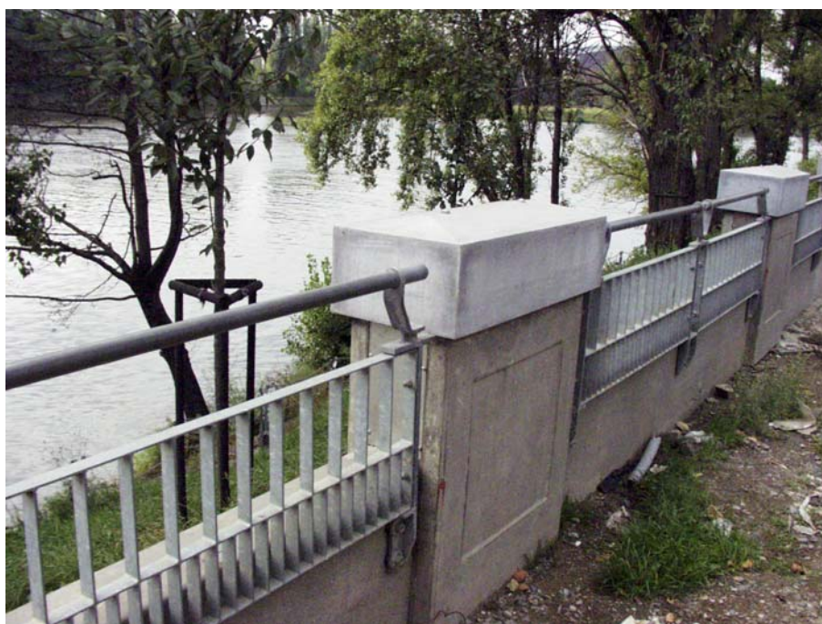
Obr. 4.9. Ukázka železobetonové protipovodňové zídky zabudované do nábrežního zábradlí včetně kotevních profilů pro mobilní hrazení skrytých za zábradlím (Praha – Holešovice, Bubenské nábreží)
