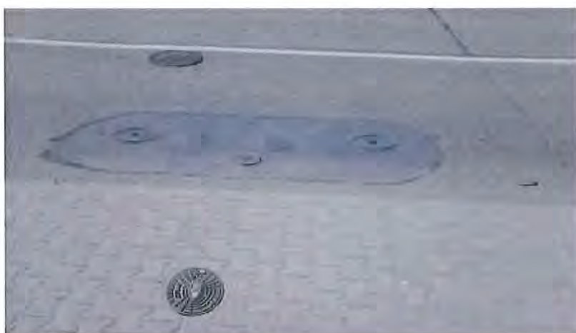
Obrázek 12 V jízdnicích stopách vodovodní kohouty, vpusti nebo šachtové poklopy, častý nedostatek na komunikacích v Brně. I když by se pro hromadnou dopravu používal tišší trolejbus a vodovodní potrubí jsou z plastické hmoty, pořád se přenášejí otřesy a obtěžující hluk do obytných budov, místo u domu Vyhlídalova 3. Vjezd těžkých vozidel do této ulice by se měl zakázat.
